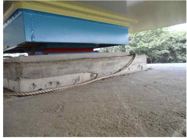
P1-Sh2 받침콘크리트 균열 (Cw=0.3mm미만)
