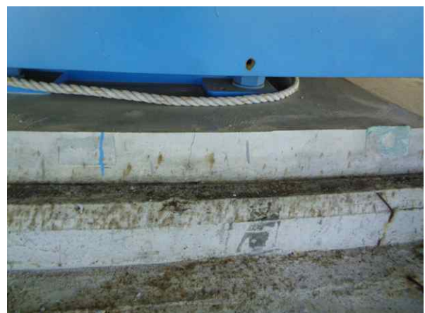
P7-Sh1 받침몰탈 균열 (Cw=0.3mm미만)
