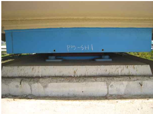
P5-Sh1 받침몰탈 균열 (Cw=0.3mm미만)
